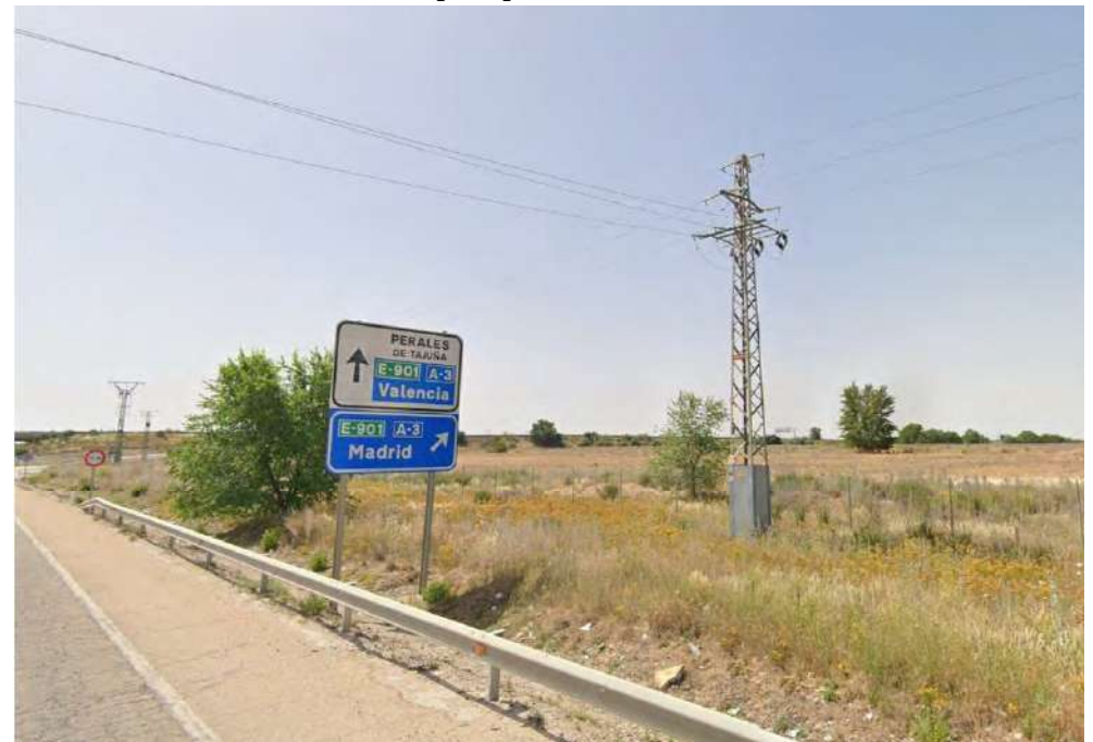
Foto 4: Línea MT-8, margen derecho N-III dirección Perales de Tajuña
