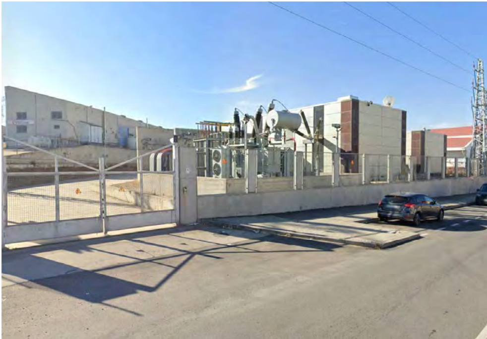
Foto 9: Subestación 1, Camino San Martín de la Vega 19
