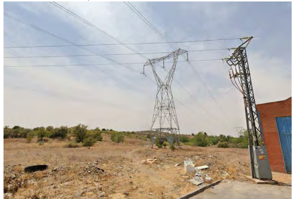
Foto 8: Líneas AT-2 y MT-6, en esquina de C. Sodio con C. Río Tajo
