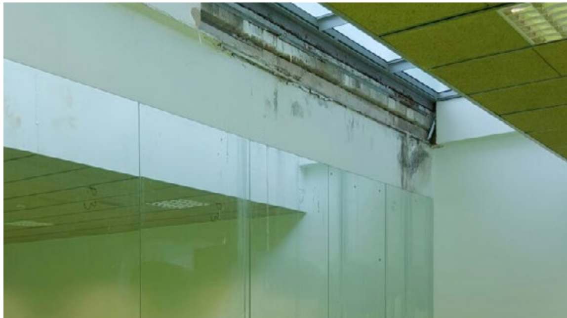
Detalle del estado de abandono de una de las salas ocultas del polideportivo Virgen del Carmen de La Poveda
